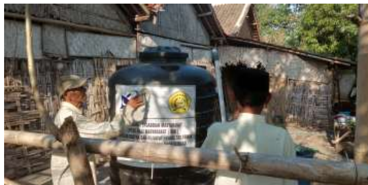
Gambar 2. Pengadaan Air Bersih di Dusun Pelan Kerep
