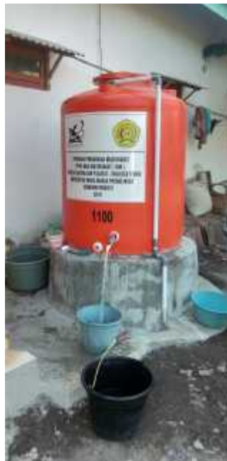
Gambar 6. Tandon Air yang Dipasang di Lokasi
