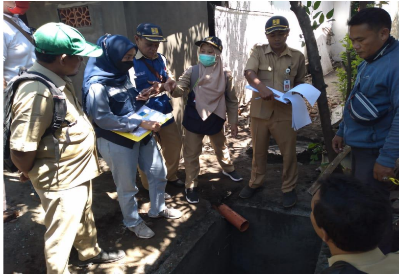
Gambar 4.14 Pengawasan Lapangan oleh Dinas Perumahan, Kawasan Permukiman dan Pertanahan Kabupaten Probolinggo, Pemerintah Desa Randuputih dan Kelompok Masyarakat
