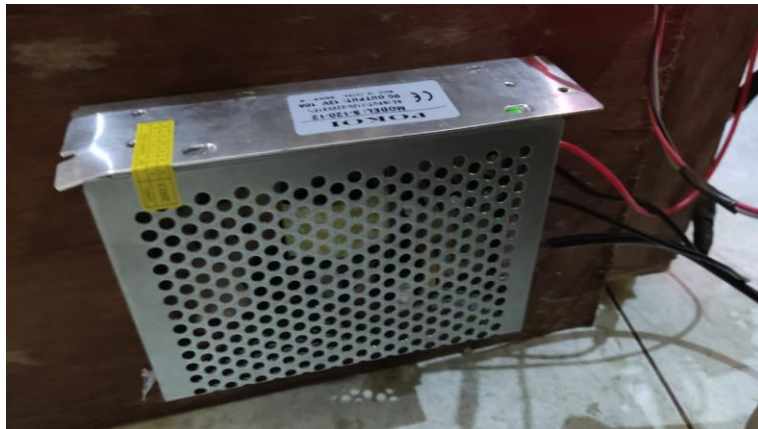
Gambar 4.13 Trafo Adaptor Sebagai Penurun Tegangan
