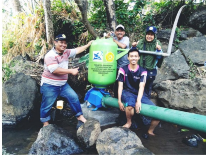
Gambar 5. Pompa Air Dongki Telah Terpasang di Sungai Paras
